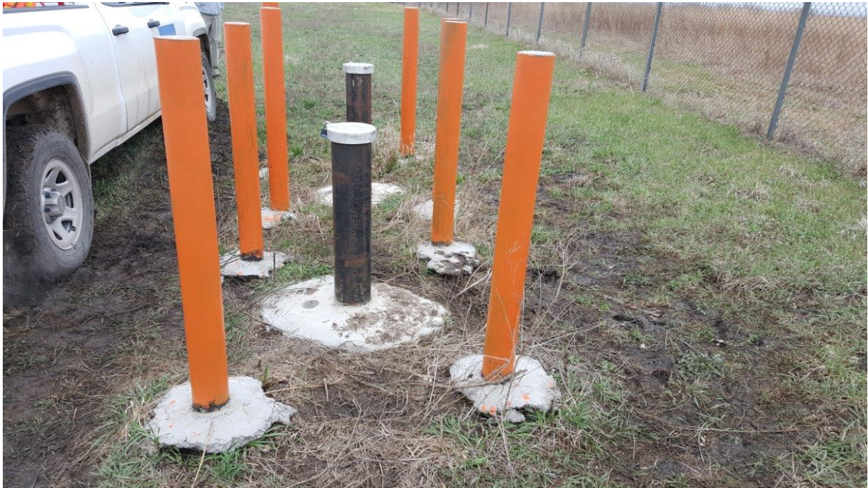
Photo 4. MW-04S and MW-04D.
